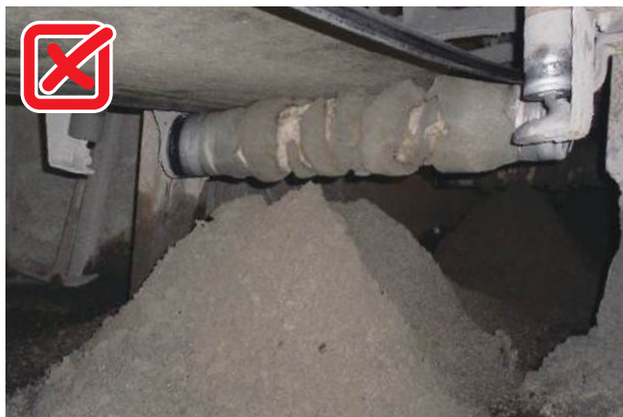
ローラに付着し下部にも落下した運搬物
